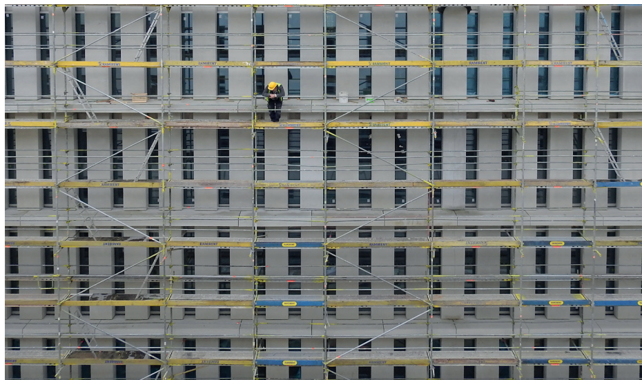
Budowa gmachu komisji sejmowych (bud. U), 11.03.2017 r. Fot. Jerzy Woźniak. Biblioteka Sejmowa
